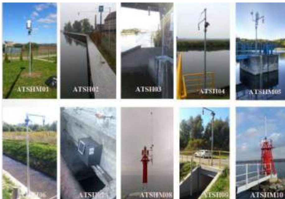
Zdjęcia stacji pomiarowych
