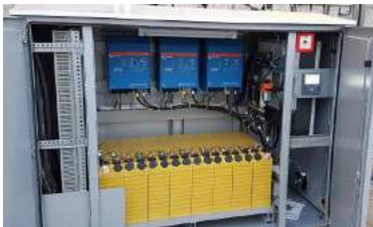
Instalacja hybrydowa parkingów Parkuj i Jedź
